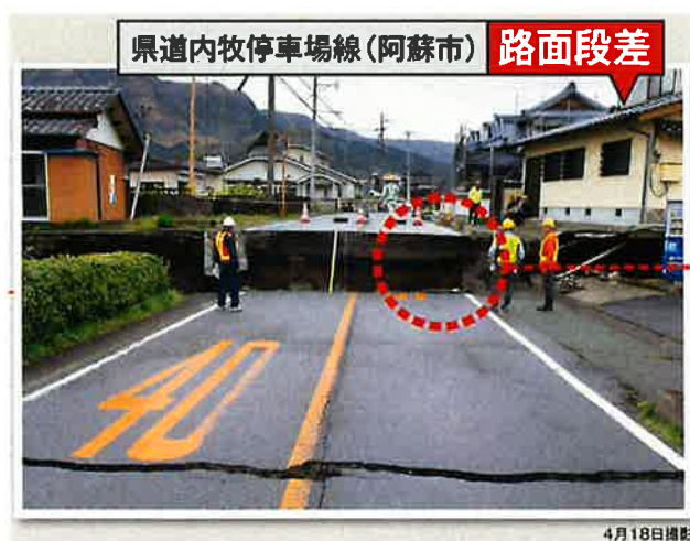
図 32 阿蘇市の道路支障箇所
