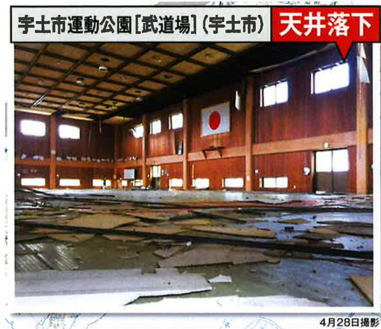
図 24 公共施設の損傷事例
