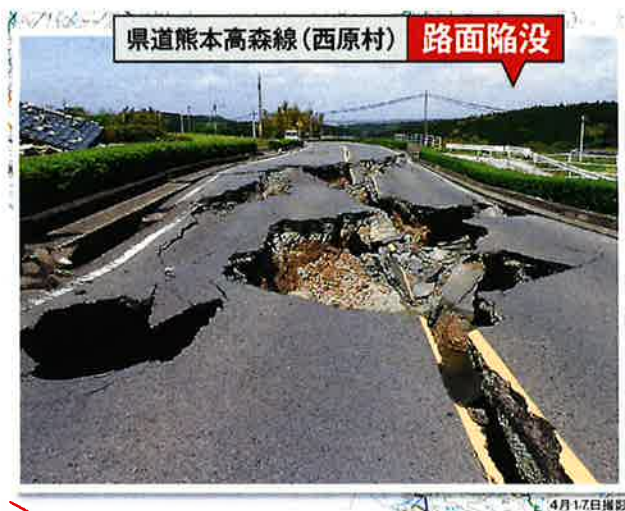
図 31 西原村の道路支障箇所
